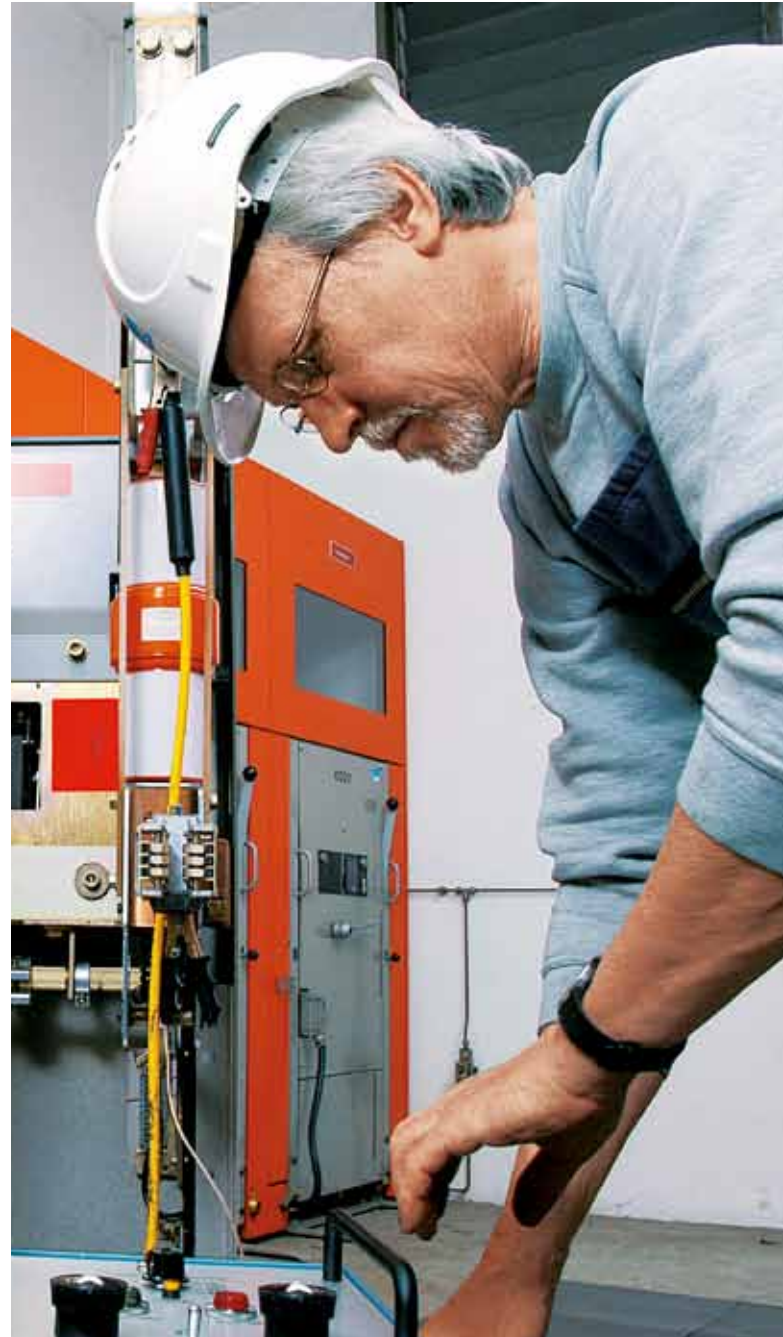
Eine Vakuumröhre an einem MS-Schalter wird geprüft.
