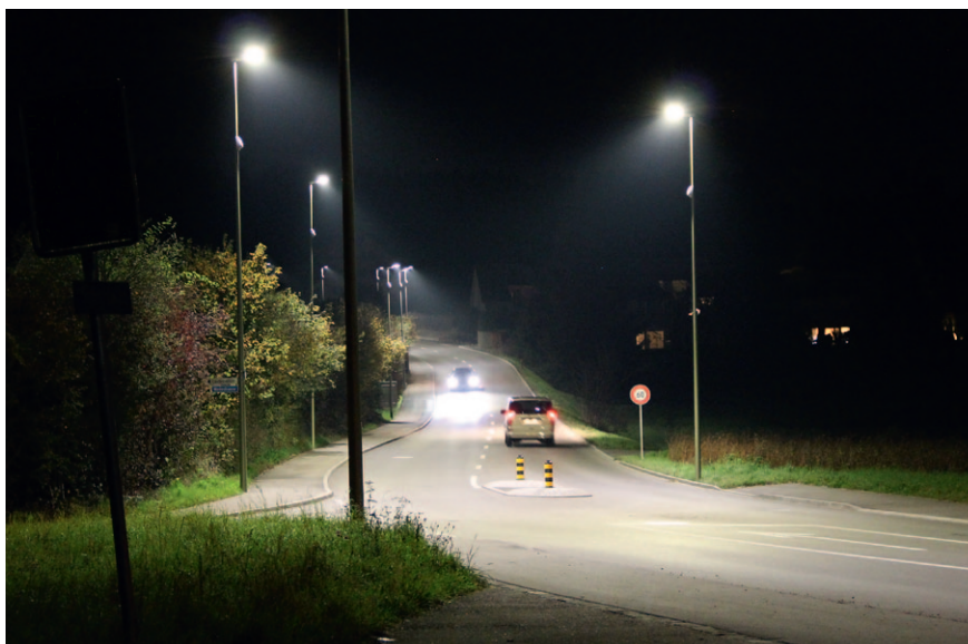
Bild 1 Anlage mit Radarsensoren und LED-Leuchten in Regensdorf.
