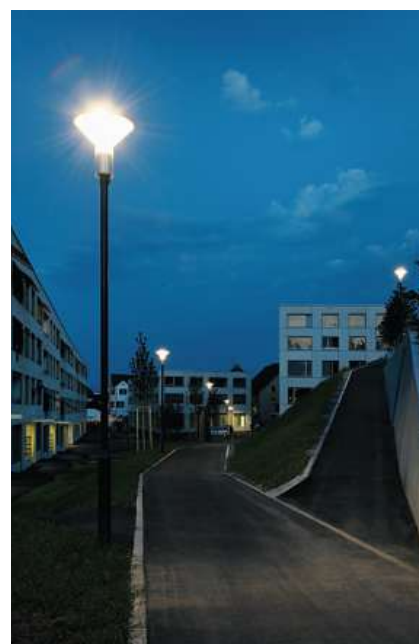
Bild 1 LED-Wegleuchten mit indirekter Beleuchtung. Statt dieser dekorativen Lösung werden in der Regel direkte Optiken eingesetzt.
