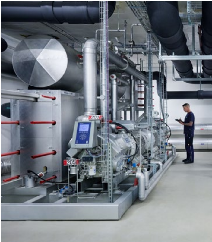
Zentrale und leistungsstarke Wärmepumpe für eine Wohnsiedlung und Gewerbe
