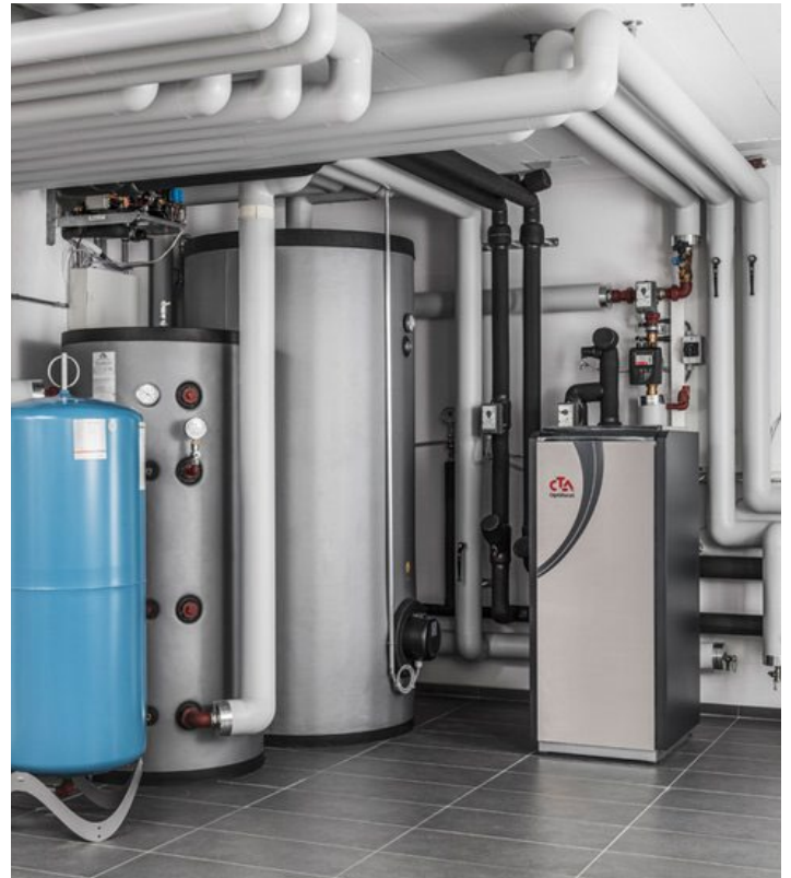
Moderne und energieeffiziente Wärmepumpe in einem Mehrfamilienhaus
